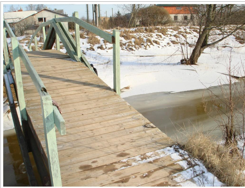
49. fotoattēls Vandālisma rezultātā bojātas tilta margas
