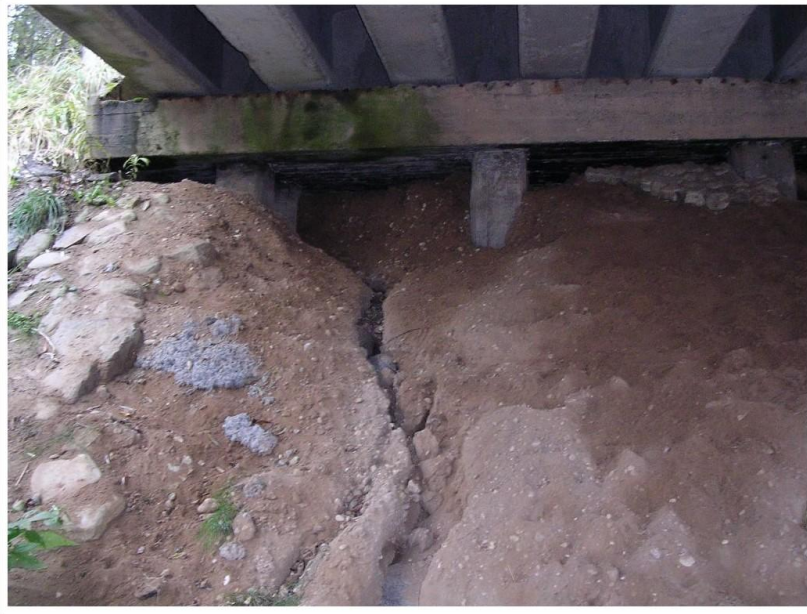
4. fotoattēls Neskatoties uz to, ka krasta balsta pamatu pāļi ir atsegti, to nestspēja nav mazinājusies
