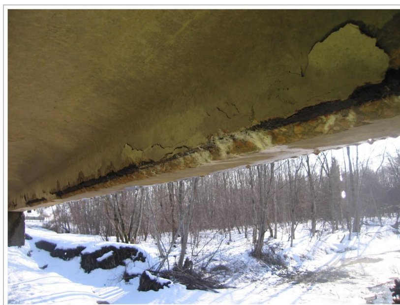
25. fotoattēls Nepietiekama biezuma betona aizsargslānis, kā rezultātā korodē gan darba, gan nesošais stiegrojums.
