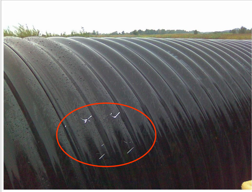
38. fotoattēls Bojāts tērauda caurtekas pārklājums
