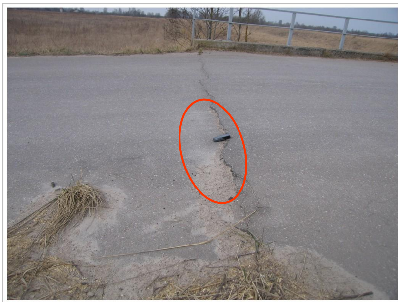
13. fotoattēls Iesēdums ceļa segumā pirms tilta
