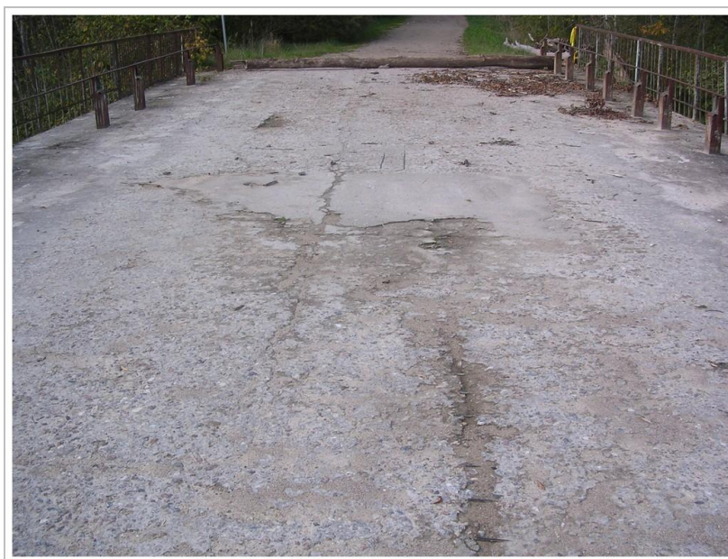
45. fotoattēls Izdrupumi cementbetona brauktuves segumā
