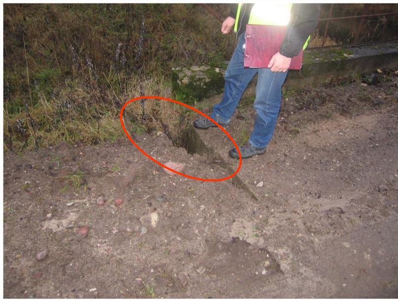
14. fotoattēls Izskalojums ceļa segumā pirms tilta
