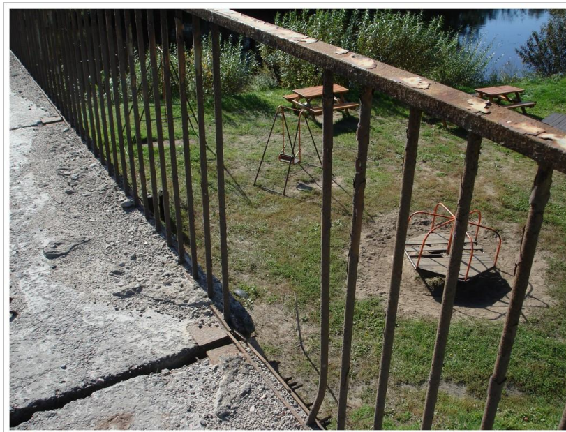
47. fotoattēls Vandālisma rezultātā bojātas tilta margas
