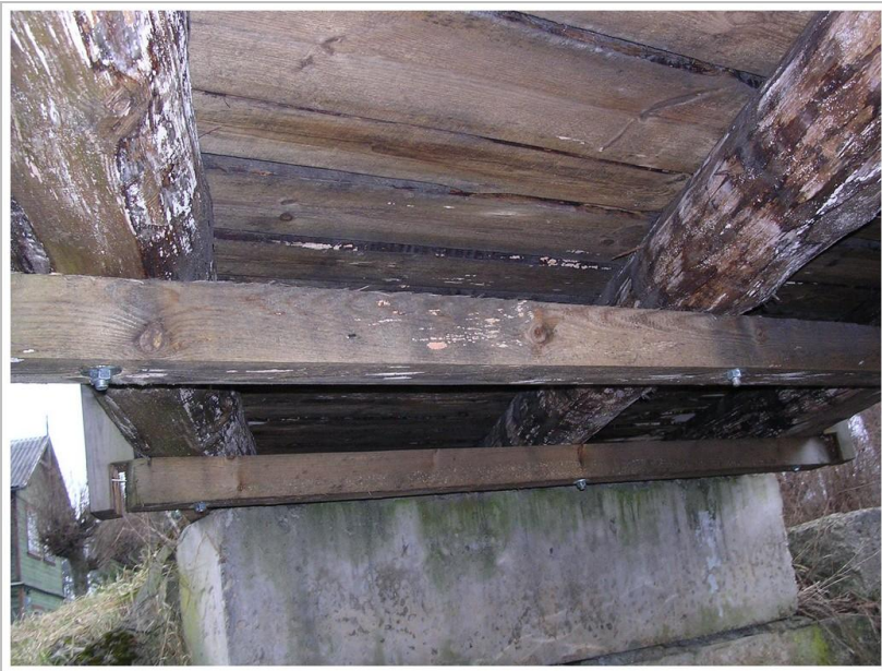
28. fotoattēls Koka trupēšanas pazīmes laiduma konstrukcijai
