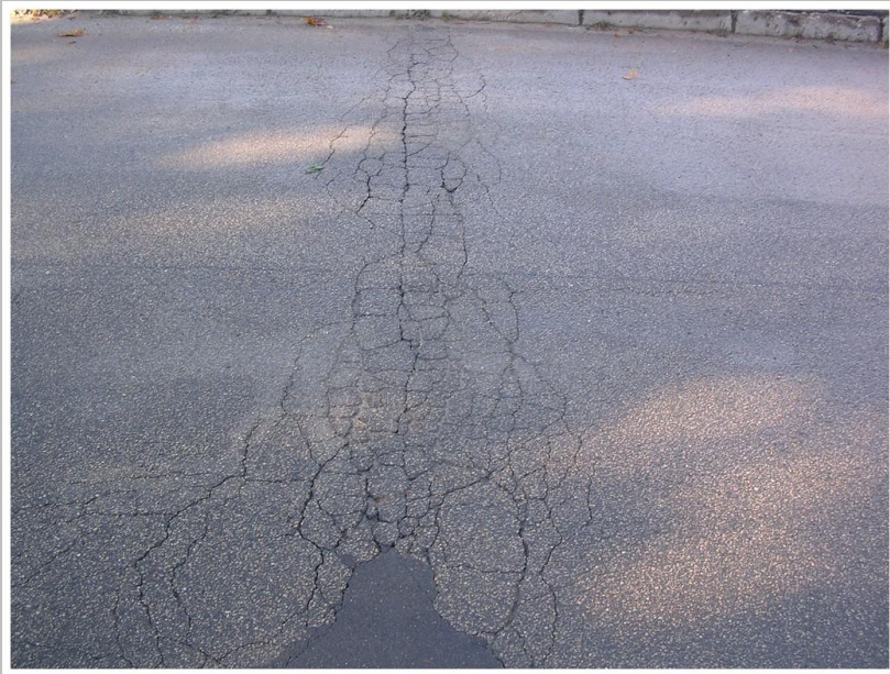
40. fotoattēls Saplaisājis asfalbetona segums virs deformācijas šuves
