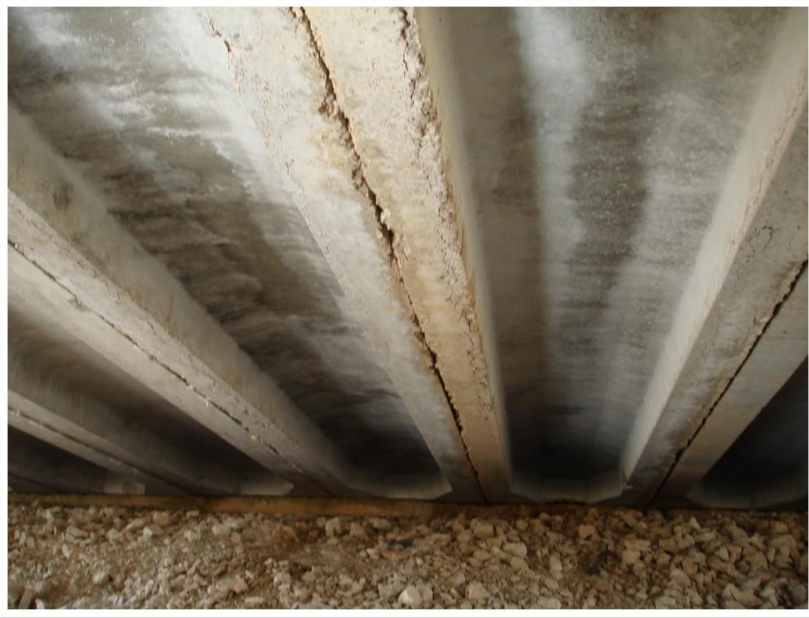
43. fotoattēls Ūdens caursūkšanās caur brauktuves plātņi
