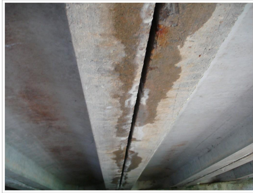
27. fotoattēls Ūdens sūcas caur plātņu šuvēm
