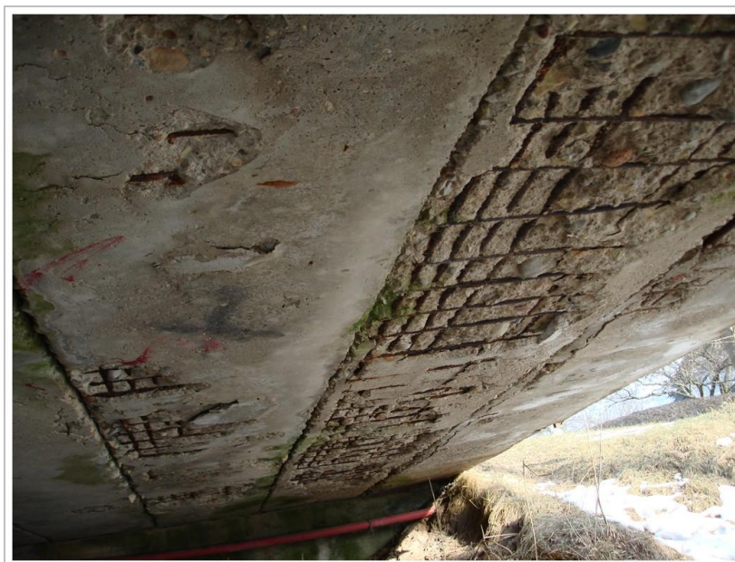
20. fotoattēls Nepietiekama biezuma betona aizsargslānis; tā rezultātā korodē gan darba, gan nesošais stiebrojums
