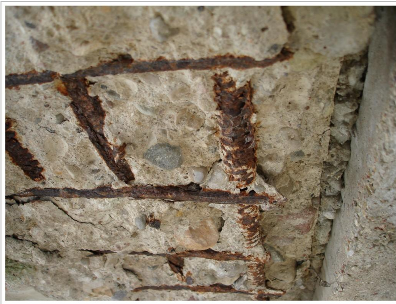
19. fotoattēls Sliktas kvalitātes betons, rezultātā — izdrupumi
