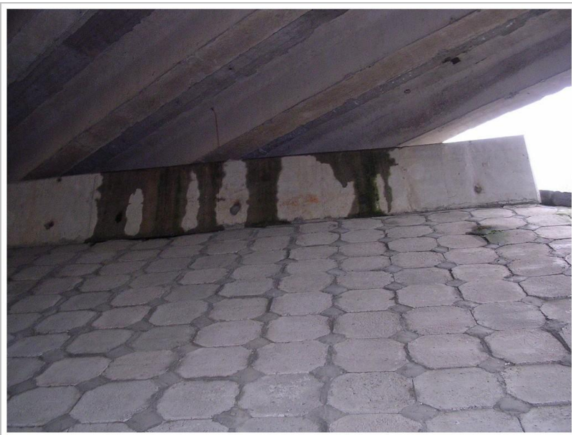
41. fotoattēls Cauri deformācijas šuvei sūcas ūdens
