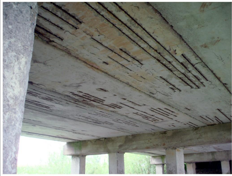
24. fotoattēls Nepietiekama biezuma betona aizsargslānis, kā rezultātā korodē darba stieņojums
