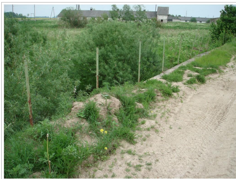
56. fotoattēls Smilts sanesumi uz tilta konstrukcijām neļauj tām izžūt
