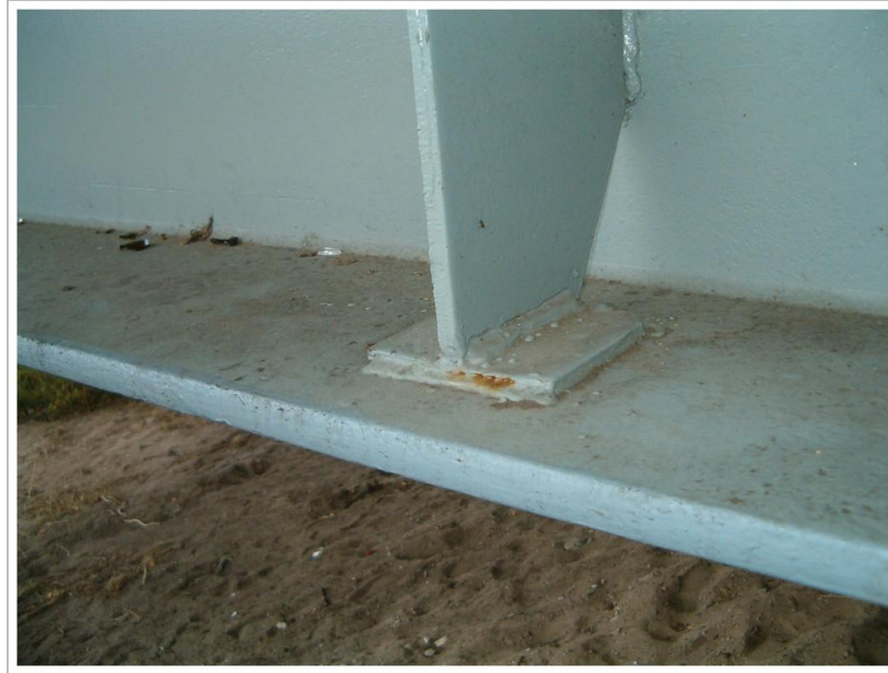
32. fotoattēls Korozija metinājumu vietās
