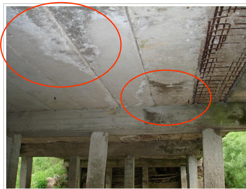
23. fotoattēls Ūdens sūcas caur plātņu šuvēm
