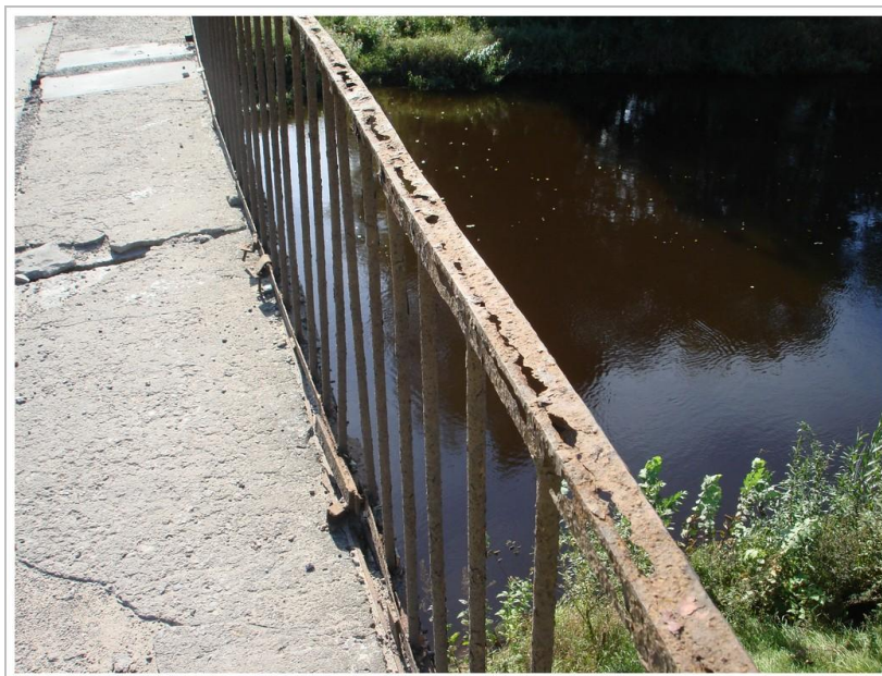
48. fotoattēls Stipra margu korozija
