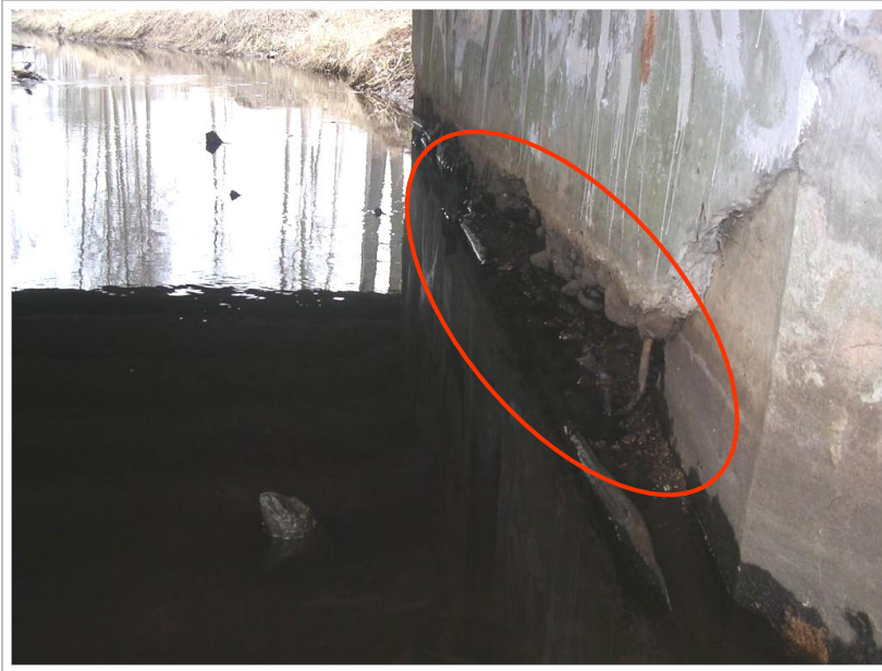
5. fotoattēls Izdrupis krasta balsta ķermeņa betons ūdens mainīgajā zonā
