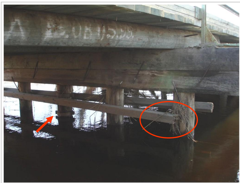
8. fotoattēls Bojāta šķērsvirziena saite upes balstam, remontēts 3. pālis no augšteces puses
