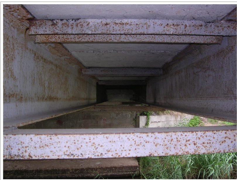
30. fotoattēls Tērauda siju vispārējā korozija
