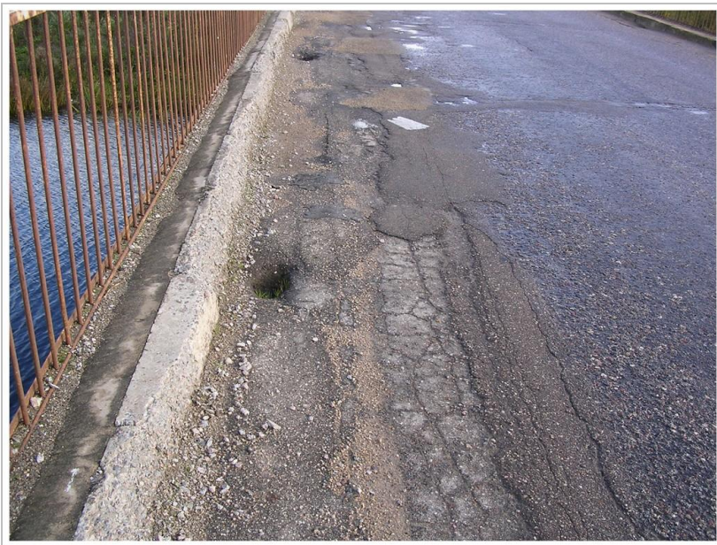
44. fotoattēls Plaisas un bedres asfaltbetona brauktuves segumā
