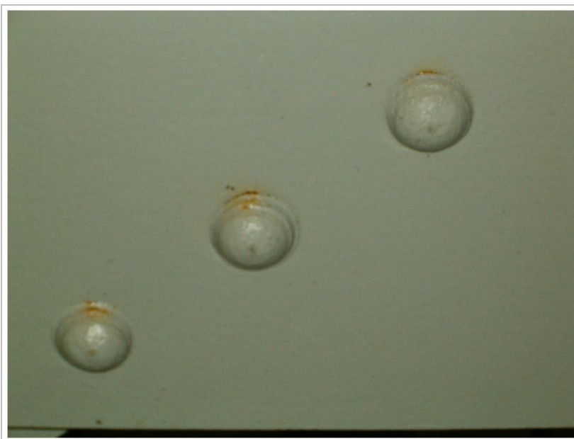
31. fotoattēls Korozija kniedējuma vietās
