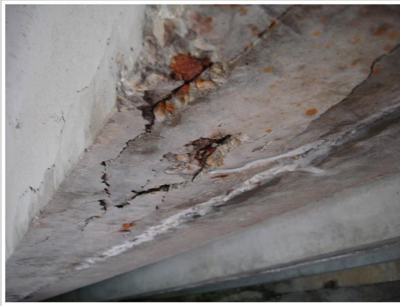
26. fotoattēls Korozijas plaisas laiduma konstrukcijas ribotajā plātnē
