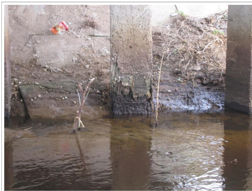
9. fotoattēls Upes balsta pālim izdrupis betons un korodē darba stiebrojums ūdens līmeņa mainīgajā zonā
